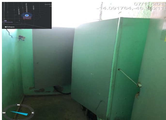
SALA QUADRO DE COMANDOS
