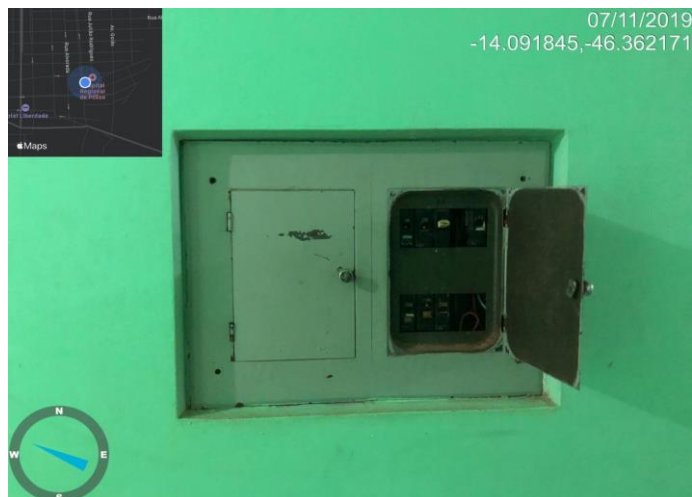
QUADRO DE ENERGIA CORREDOR
