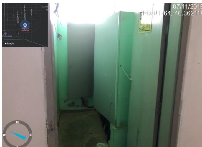
SALA QUADRO DE COMANDOS
