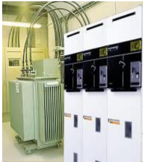
Figura 17 - Imagem ilustrativa quadro de distribuição em baixa tensão
