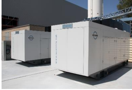
Figura 20 - Imagem de um Nobreak com fonte redundante
