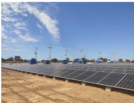
Figura 7 - Usina Solar de Solo Adelfo da Cruz Dias
